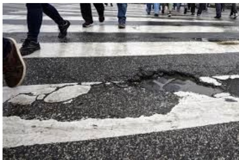
Buche e dissesti stradali
